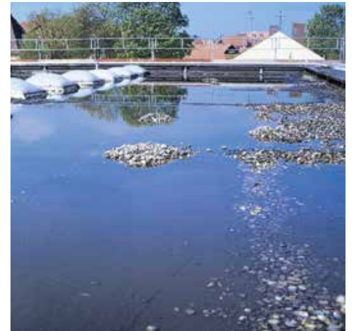
Stehendes Wasser auf einem Null-Grad-Dach
