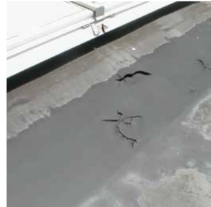
Materialschäden erfordern eine Dachsanierung
