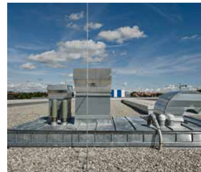
Dachaufbau lose verlegt mit Auflast
