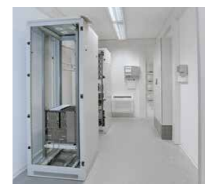
Technikraum und Servertechnik
